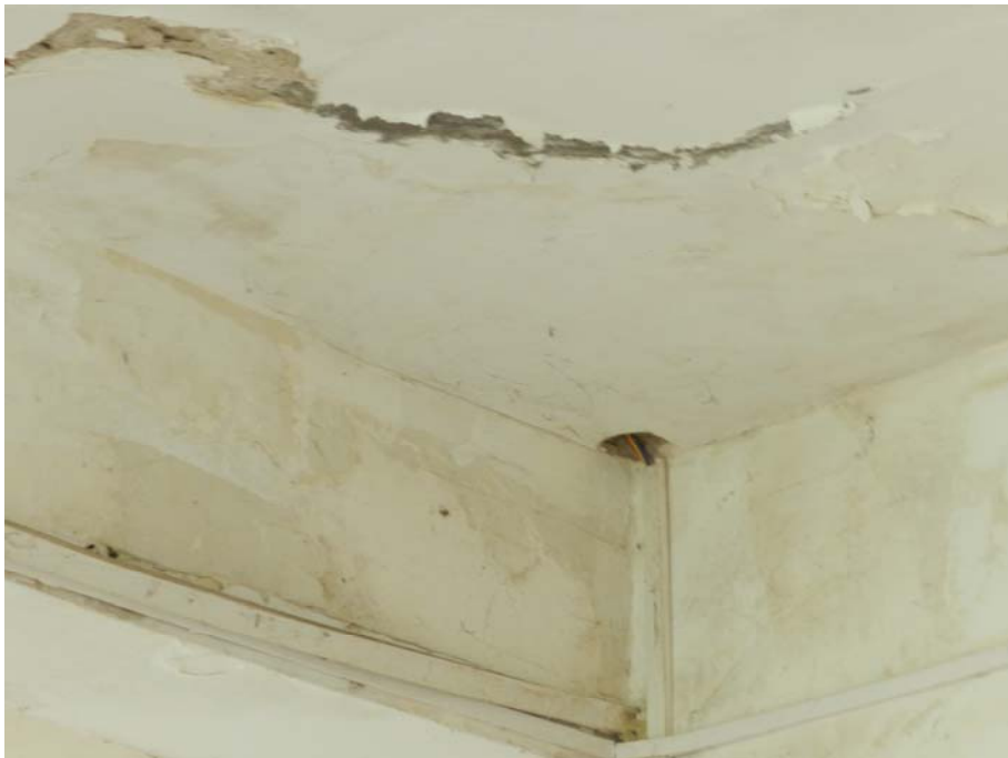
照片 2 局部渗水及粉刷层脱落
